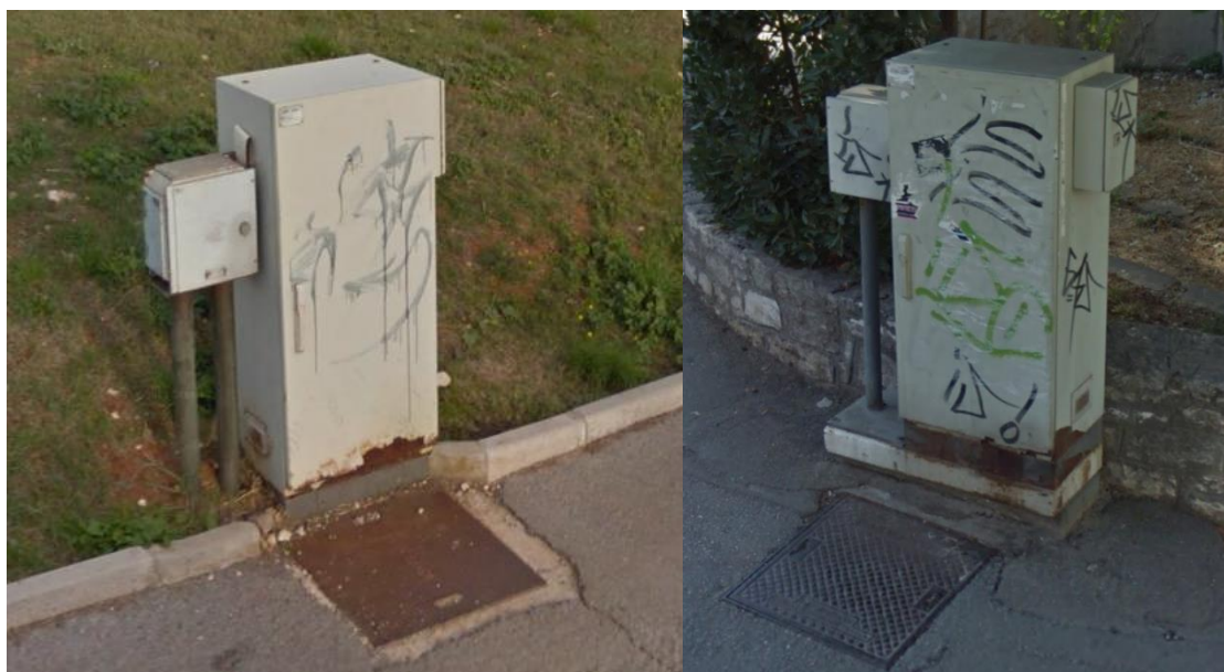
Slika 71. Korodirala kućišta semaforških uređaja
