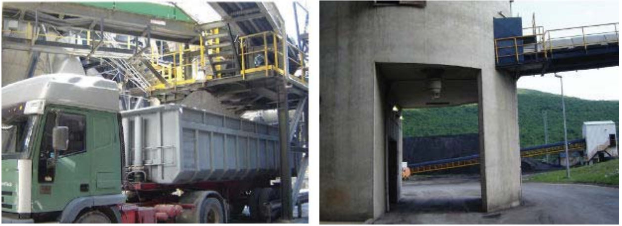
Slika 4.6-2: Utovar šljake s gumenog transporterera nakon odšljakivača TEP 2 (lijevo) i rampa za utovar ispod silosa pepela TEP 2 (desno)
