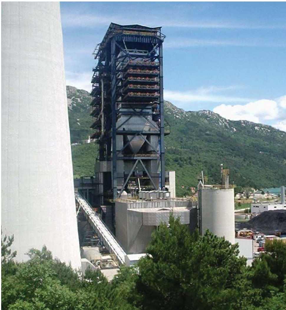
Slika 4.5-1: Postojeći sustav otprašivanja dimnih plinova TE Plomin 2
