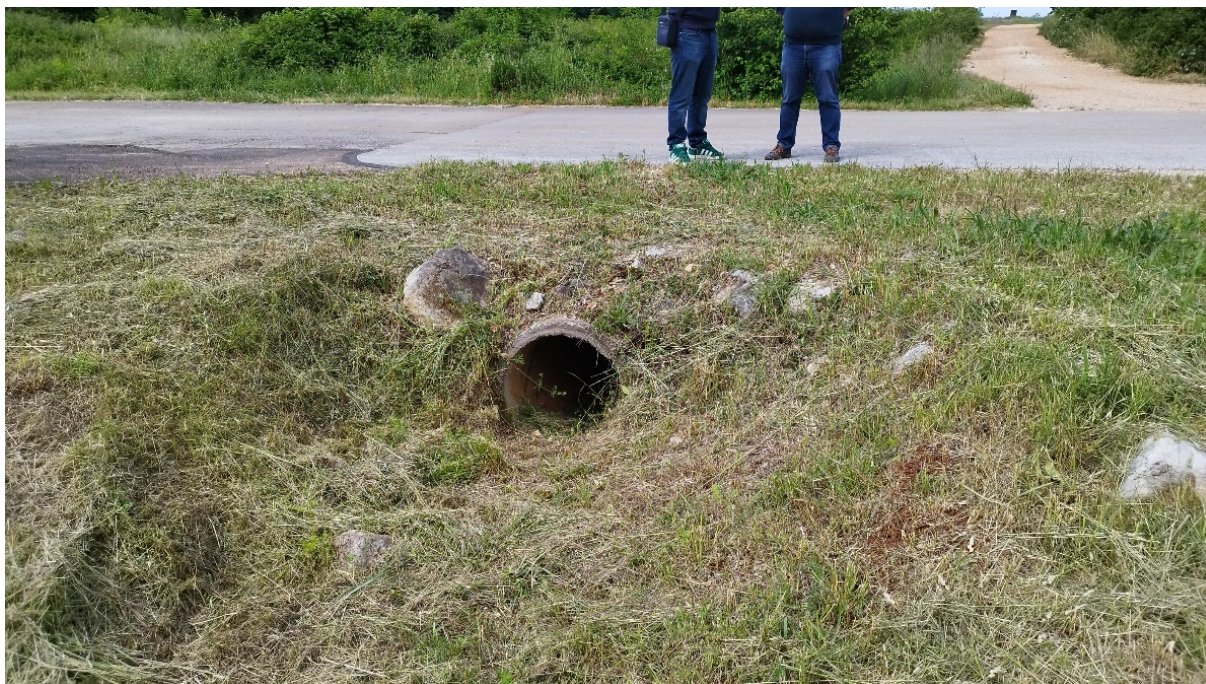
Slika 6. Postojeći cestovni propust u trupu lokalne ceste (izvor: Idejni projekt za ishođenje posebnih uvjeta, Hidro-expert d.o.o., srpanj 2025.)
