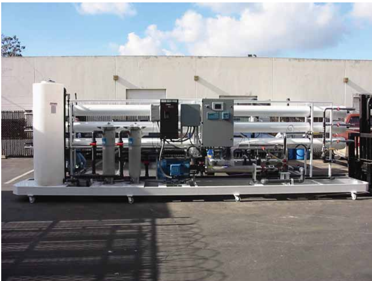
Slika 2.10-1: Postrojenje za desalinizaciju reverznom osmozom
