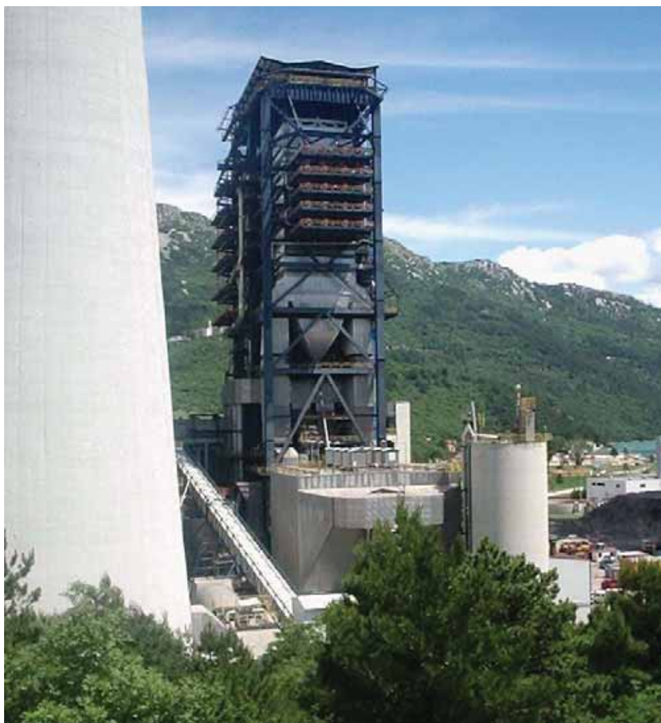
Slika 1.4.4-1: Postojeći sustav otprašivanja dimnih plinova TE Plomin 2
