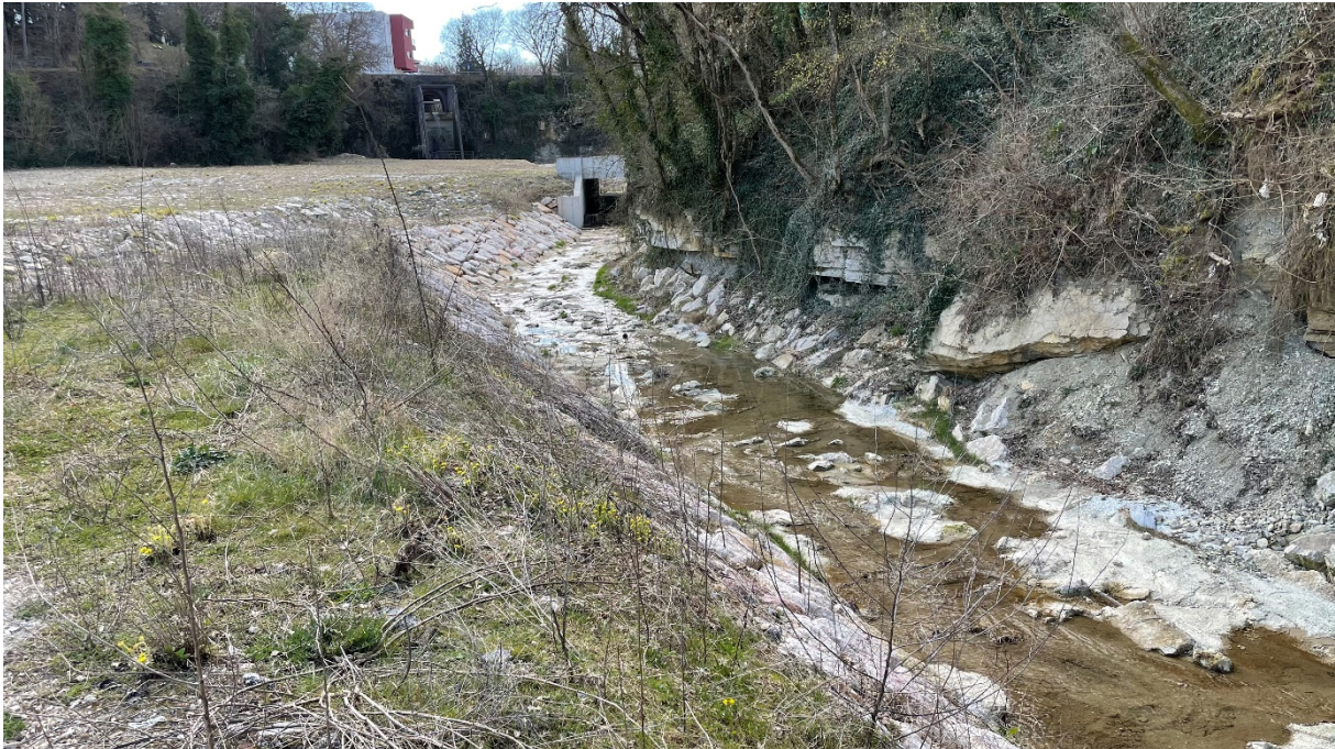
Slika 8. Postojeće stanje – kraj regulacije bujice Dražej, izvor: Vita projekt d.o.o. (ožujak, 2021.)
