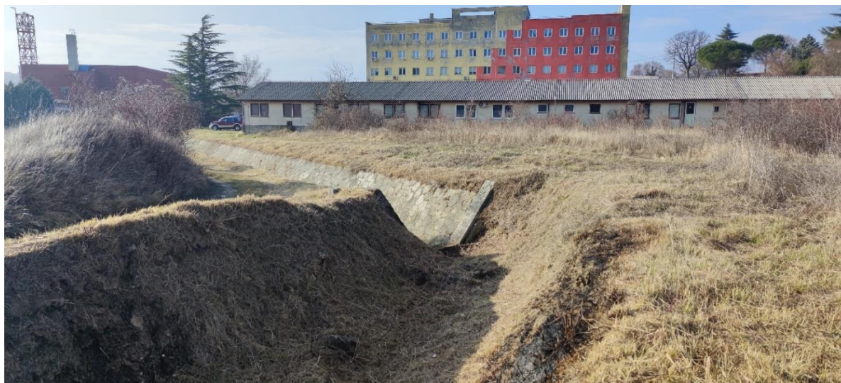
Slika 2.2-1 Spoj predmetne dionice na postojeću reguliranu dionicu (nizvodno) (Izvor: Idejni projekt, travanj 2022)
