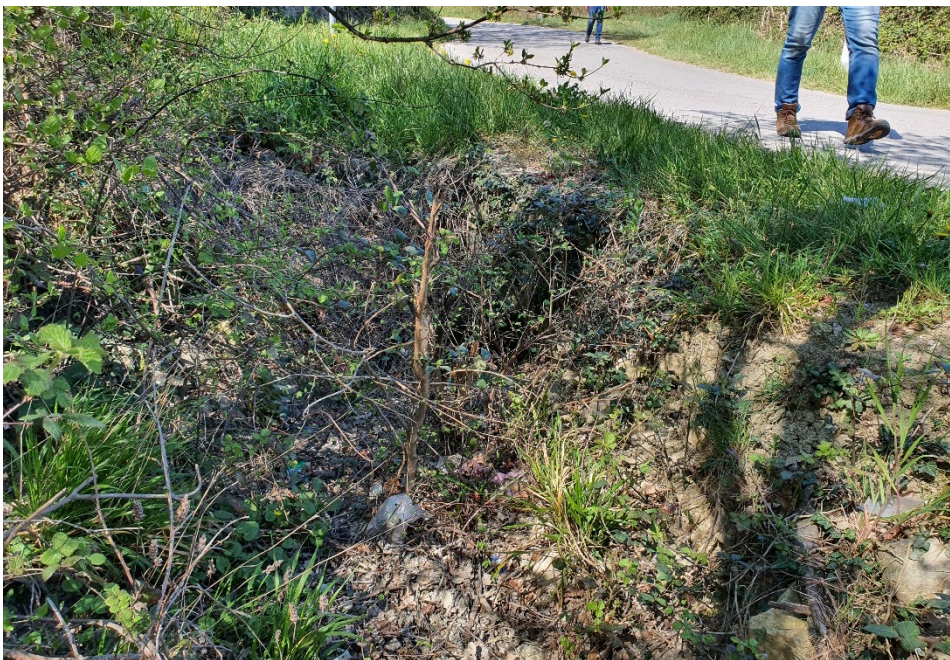
Slika 2.3.-7. Zatrpani cijevni propust na lokalnoj cesti
