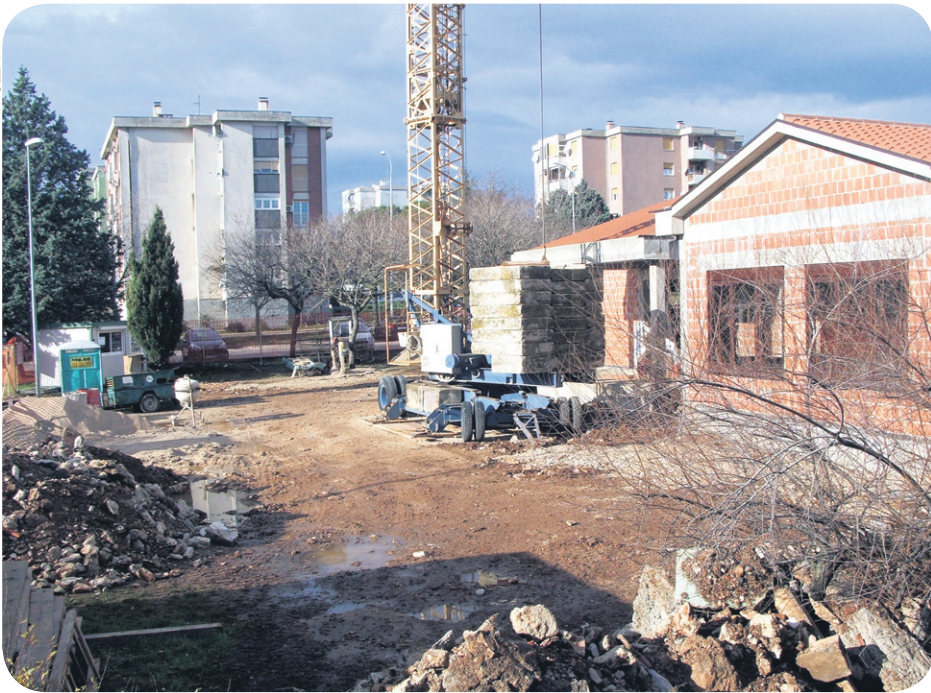
Dvorište jaslica s geotermalnom pumpom ispod zemlje
