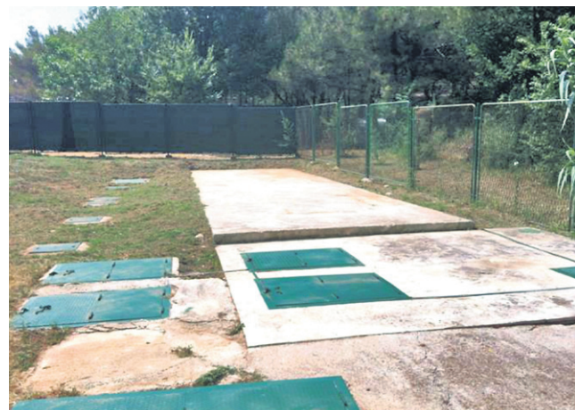
Mjesto prikupljanja otpadnih voda u kampu Stupice u Premanturi prije postavljanja uređaja...
