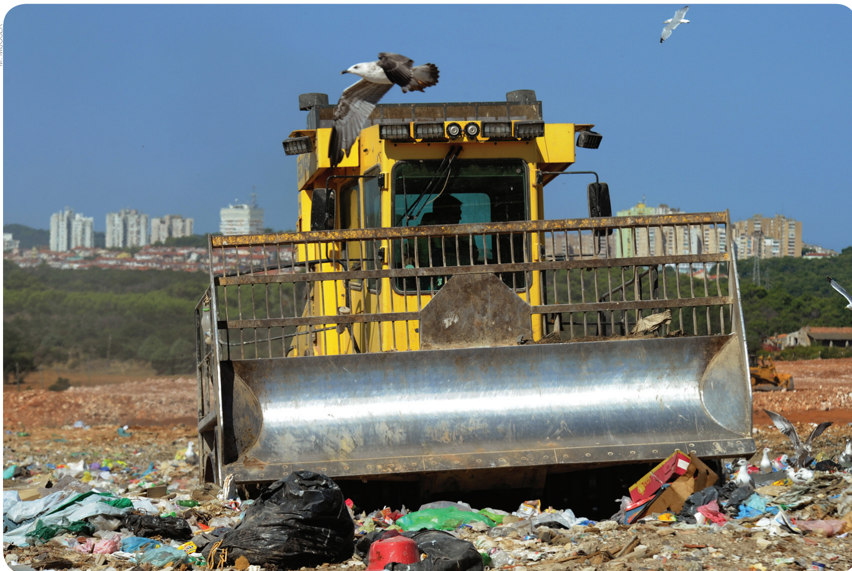
Poanta je da što manje otpada završava na odlagalištu
