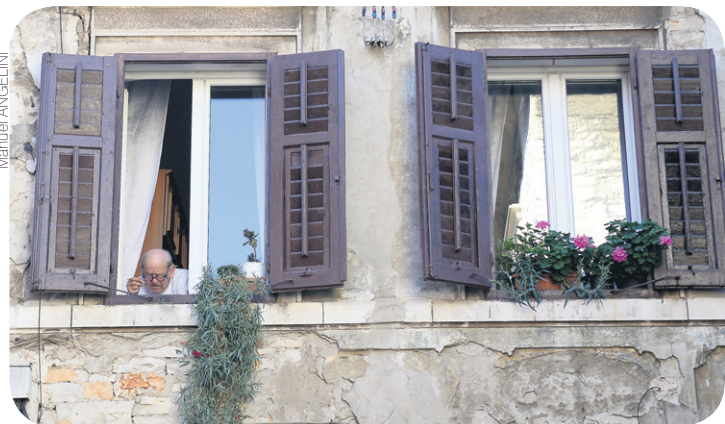
Mnoge zgrade u Hrvatskoj vaze za obnovom fasada
